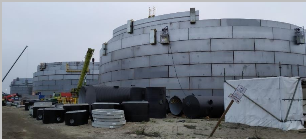
Zbiorniki paliwa Terminal Gdańsk, V=100\ 000\ m^3 , 3.500 ton
