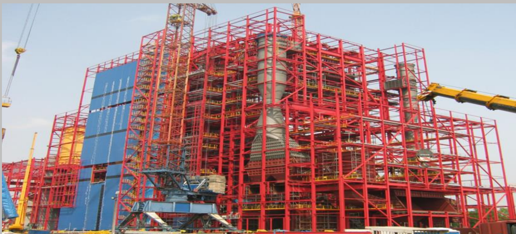
Elektrociepłownia Łągisza, 3.000 ton
