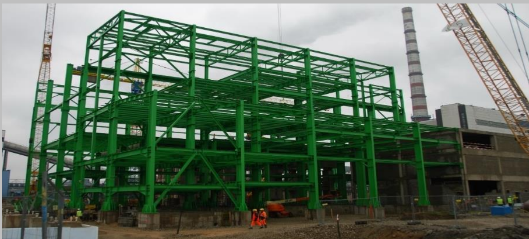
Elektrownia Narva w Estonii., 1.800 ton.
