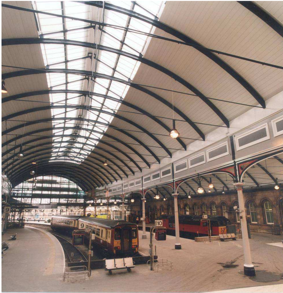
Rys. 2.2 Profilowane arkusze o jasnym kolorze powierzchni wewnętrznej, imitujące deski drewniane, zastosowane przy renowacji dachu Stacji Newcastle (Fotografia udostępniona grzecznościowo przez Corus Profiles & Panels)
