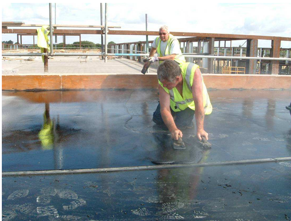
Rys. 3.6 Mastyks jest układany na powłoce filcowej i tkaninie szklanej okrywających izolację z poliuretanu, która najpierw była łączona (klejona) gorącym bitumem do filcowej warstwy paroszczelnej ( Fotografia udostępniona grzecznościowo przez Permanite Asphalte )
