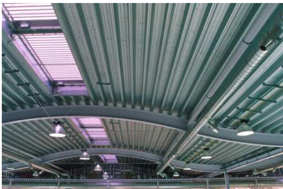
Rys. 3.3 Dach z blachy fałdowej o wysokim profilu, mocowanej do głównej konstrukcji nośnej z minimalną ilością prętowych elementów konstrukcji.
